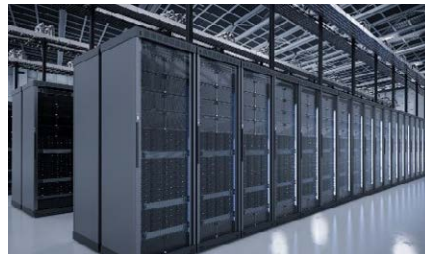
データセンター事業
