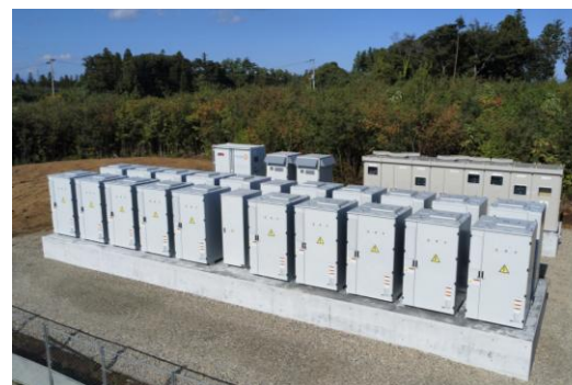
当社が運営する系統用蓄電所 (岩手北上蓄電所)
