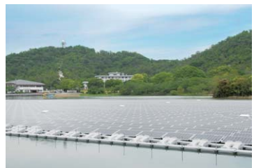
水上設置型では世界最大※となる「兵庫県・加西市逆池水上メガソーラー発電所」
