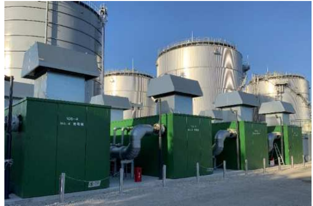
中川水循環センター消化ガス発電所
